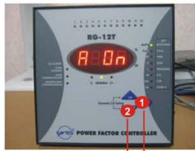
เลื่อนขึ้นลงเพื่อเปลี่ยนค่าสั่ง
