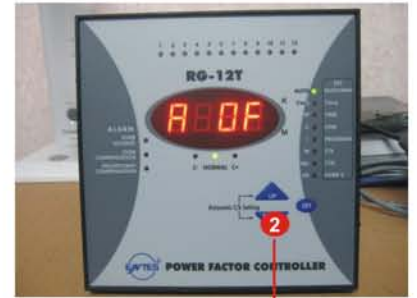
เลื่อนขึ้นลงเพื่อเปลี่ยนค่าสั่ง
